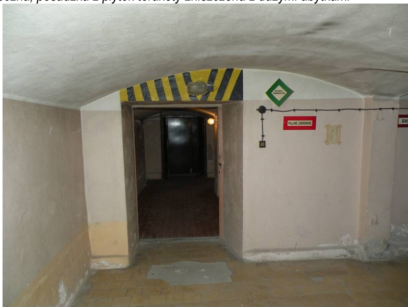
Magazyn nr 36 – przejście do magazynów 37, 38, 39, różnica poziomów 2 cm w wejściu
