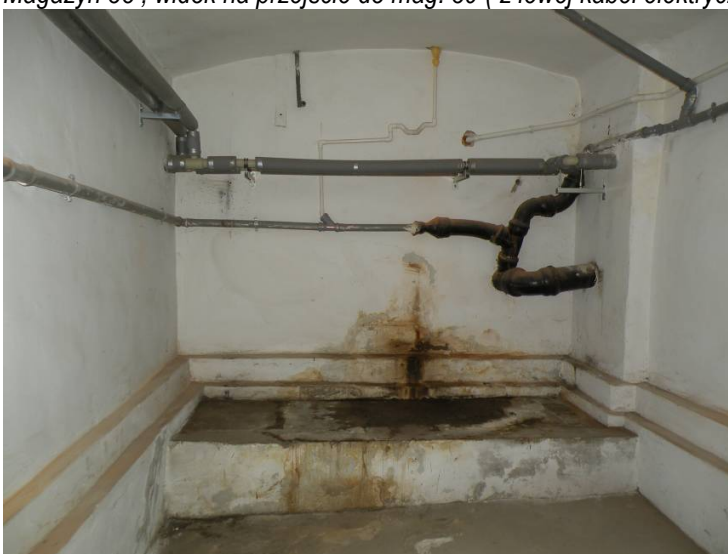
Magazyn 39 – widok podestu wys. 40cm i instalacji wod-kan – do wymiany
