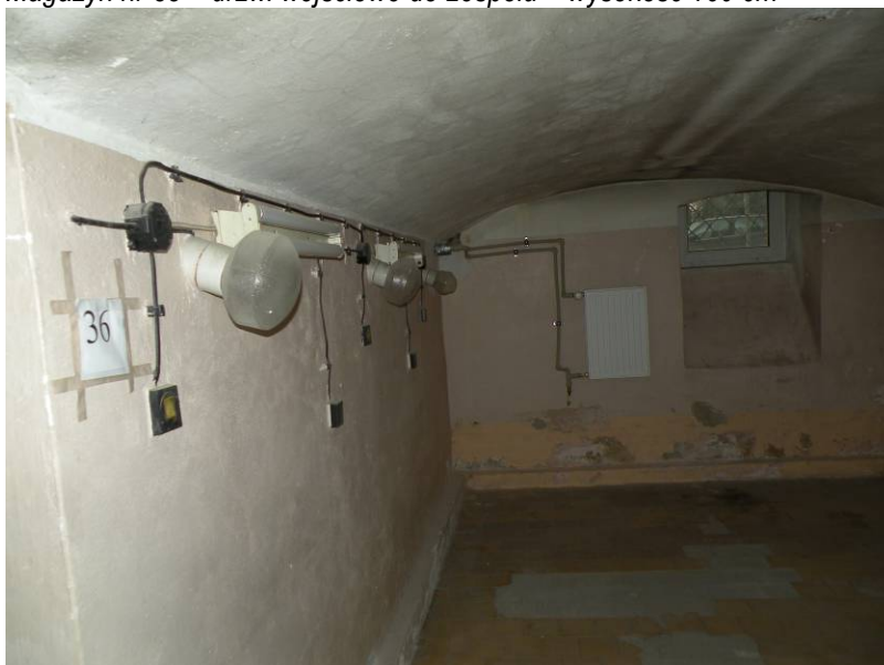
Magazyn 36 – ( instalacje CO biegnące przy ścianie zewn.), instalacja elektryczna oświetleniowa – boczna, posadzka z płytek terakoty zniszczona z dużymi ubytkami
