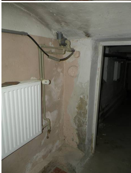
mag 37 – widok kabla elektrycznego pod stropem, ubytki tynku
