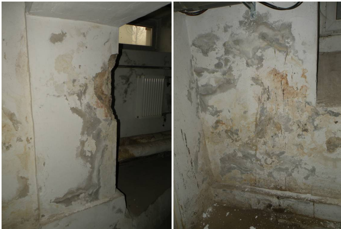
Ubytki w ścianie ceglanej i zniszczenia tynku ściany zewnętrznej
