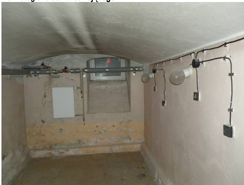
Magazyn nr 35 ( instalacje CO biegnące przy ścianie zewn. oraz w poprzek pomieszczenia), instalacja elektryczna oświetleniowa - boczna
